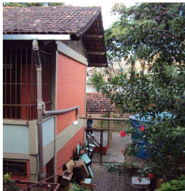
2 – Sistema de captação e uso de água de chuvas na Escola Municipal Anne Frank
