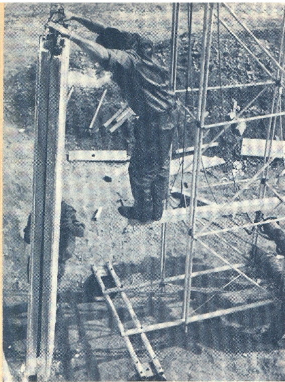
Sôbre o guincho, o operário orienta a colocação dos painéis já justapostos
