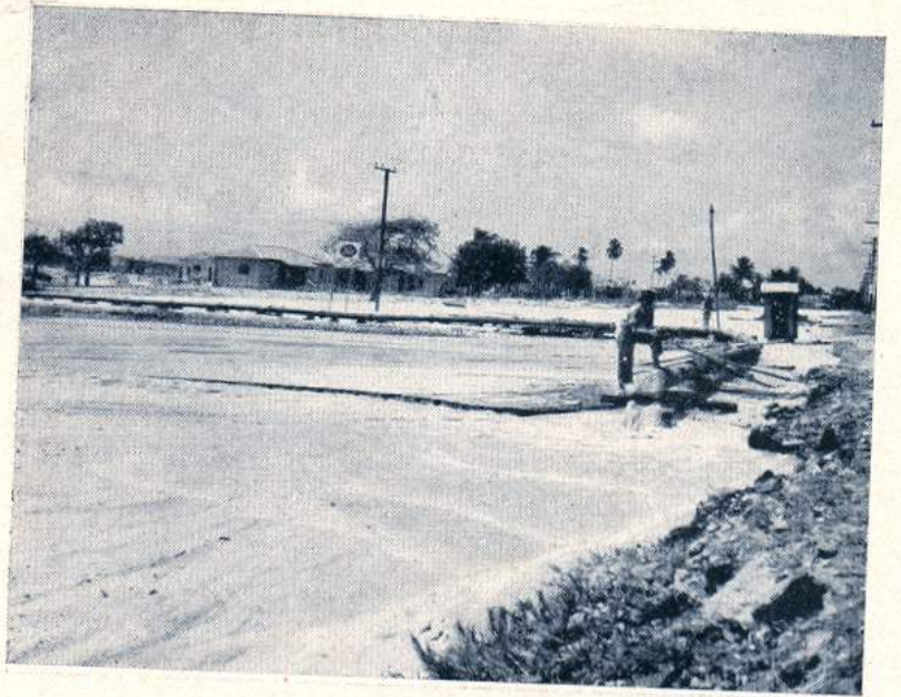
Canalisação da draga de sucção e recalque que está sendo empregada no aterro de Santo Amaro.
