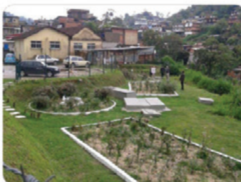
9. Petrópolis: Tratamento biológico de águas residuais
