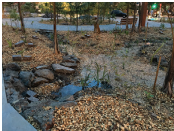
Figura 72. Após a plantação, as águas pluviais de 1 000 m 2 de superfície pavimentada foram conduzidas para o jardim de chuva e infiltradas, evitando inundações, fenômeno recorrente na região.
