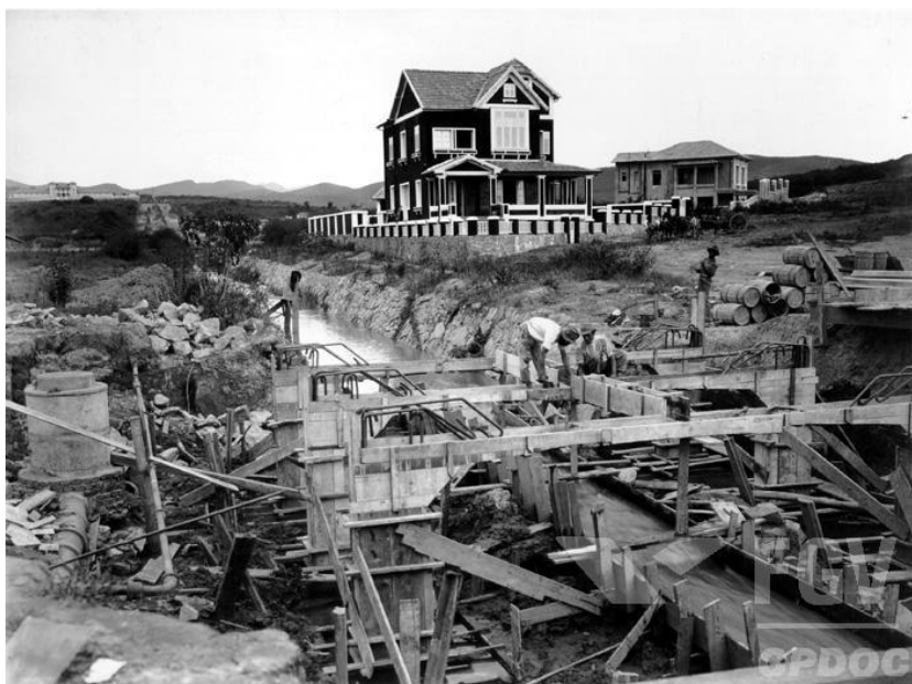
Figura 5: Obras de canalização do córrego do Leitão na rua São Paulo, década de 1920
