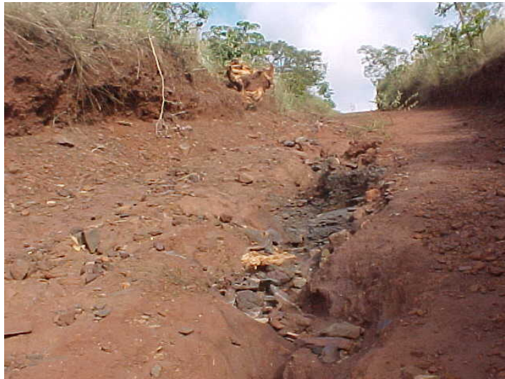
Figura 15: Início de processo erosivo da estrada de monitoramento da EE Cercadinho. Fonte: Mendonça, Luís; 2003.
