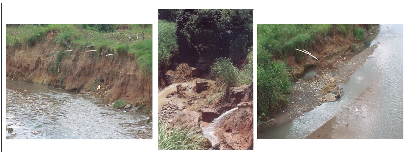
FIGURA 22: Pontos de lançamento de esgoto in natura diretamente no córrego Cercadinho Fonte: MENDONCA. Luís: 2003.
